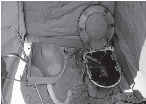
Sanitário instalado na área operacional Toilet installed in the operational area
